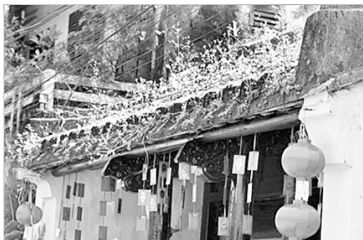
Hình 19. Rêu phong mái ngói.
